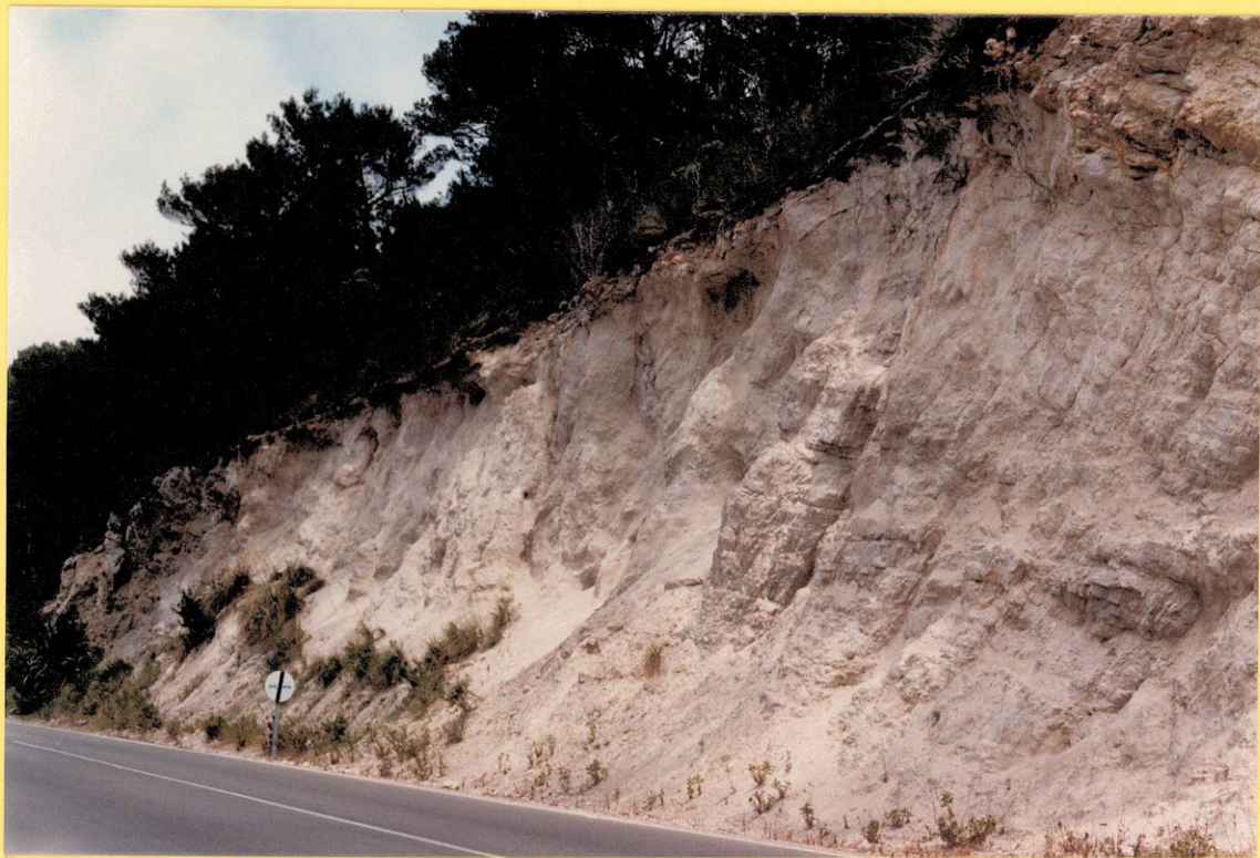
Foto 13. Talud en la carretera hacia Macaret, en materiales margosos de la Zona II 3 .
