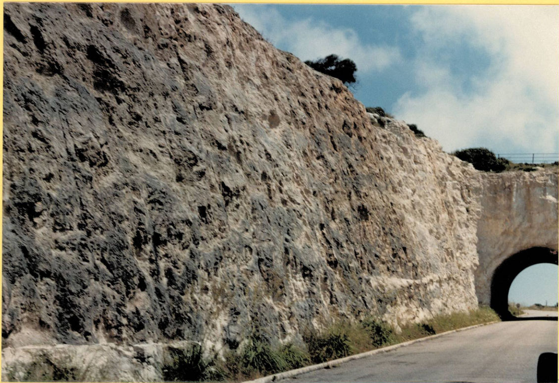
Foto 18. Taludes estables y túnel sin soportes, en las calizas de la Zona Geotécnica III 2 . Carretera de acceso a Sant Bou.
