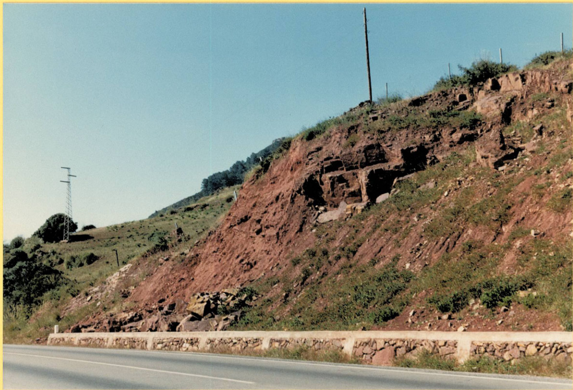
Foto 15. Inestabilidad con caída de bloques de los niveles superiores en materiales pérmicos. Carretera general de Mahón a Ciudadela.
