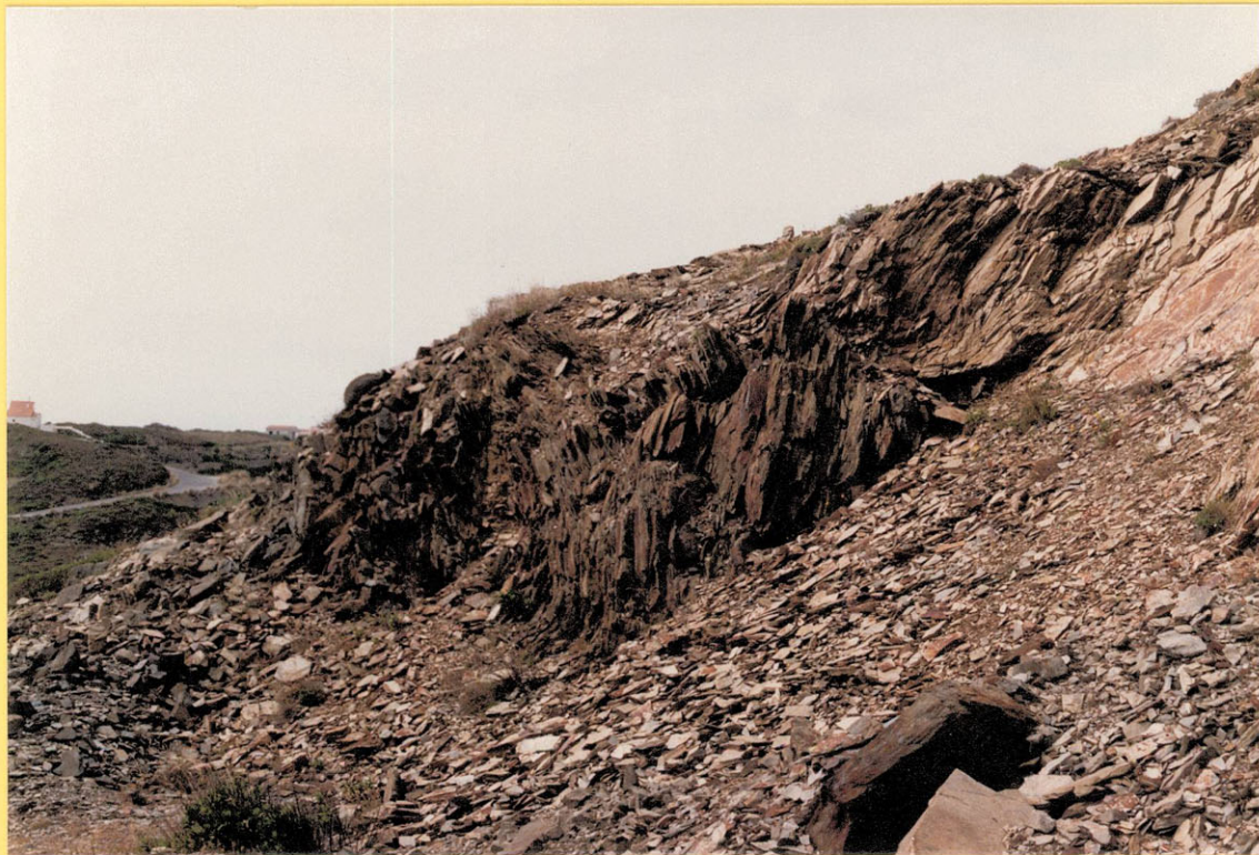
Foto 5. Aspecto de los taludes artificiales en la Zona I_2 con frecuente caída de lajas.
