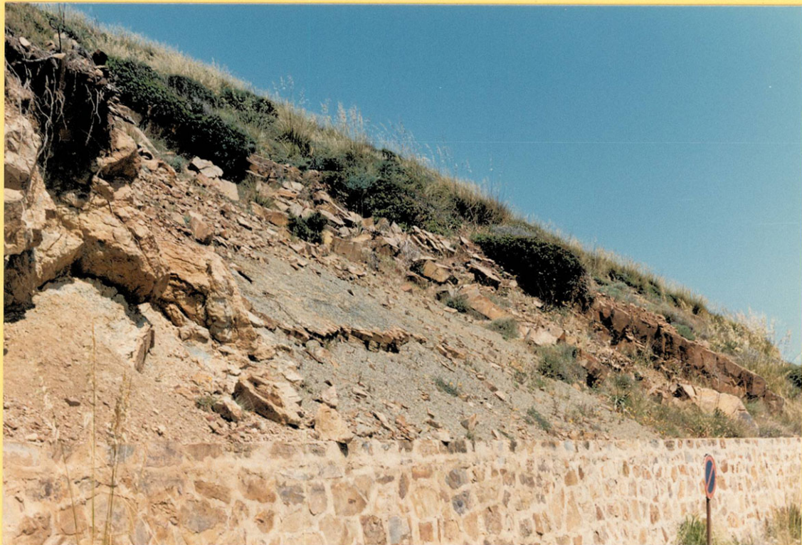
Foto 14. Caída de pequeños bloques en talud artificial en la Zona Geotécnica I 1 . Urbanización Cala Tirant.
