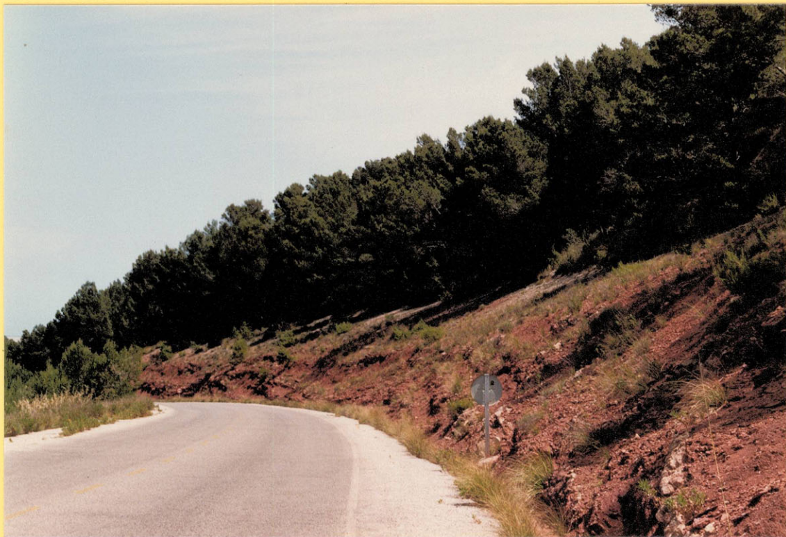
Foto 8. Talud en materiales triásicos, Zona II 1 en la carretera de acceso a Son Parc. Observese que la inclinación de los árboles indica fenómenos de inestabilidad.
